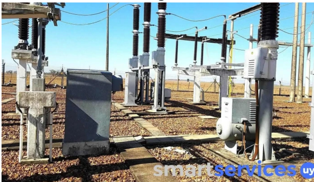
Sub estacion 150kv tomas gomensoro tomas gomensoro
