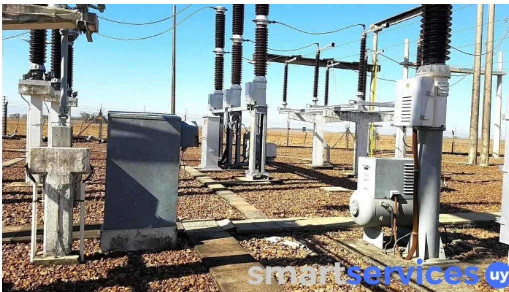
Sub estacion 150kv tomas gomensoro opiniones
