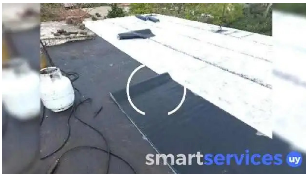
Mr impermeabilizaciones del propietario
