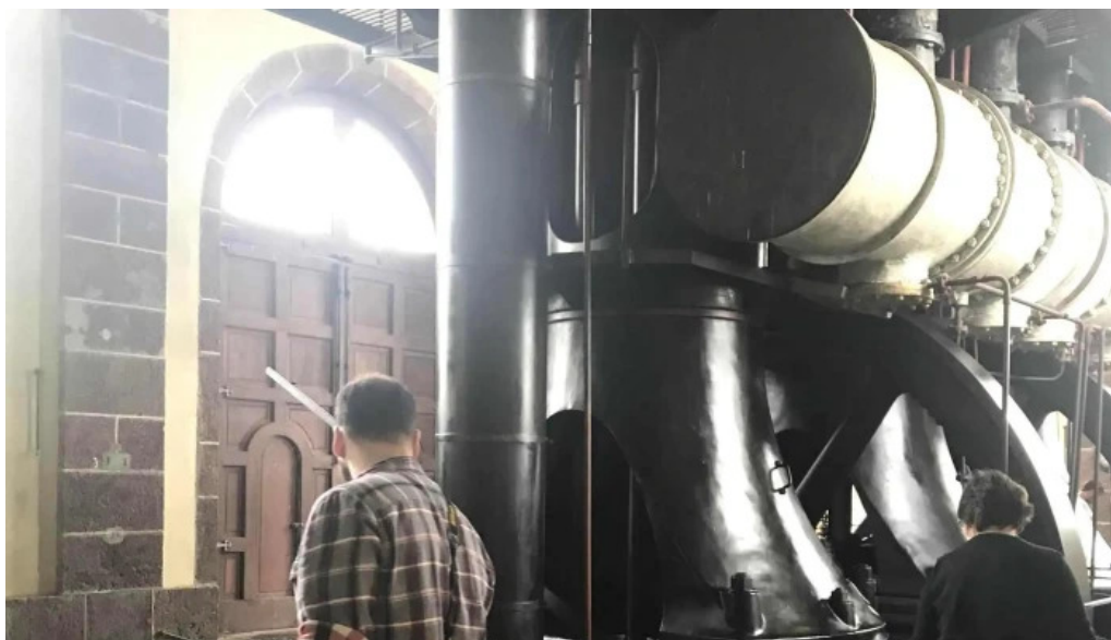
Planta potabilizadora de aguas corrientes ose aguas corrientes
