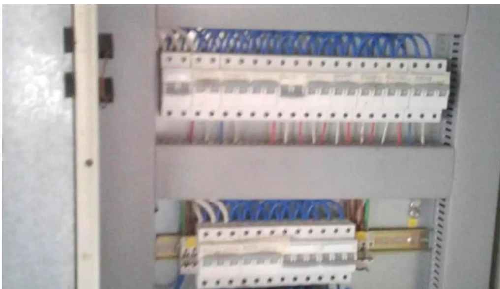
Instalaciones electricas uv instalaciones
