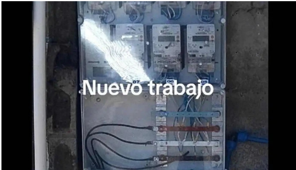
Electricista en san carlos maldonado electricista
