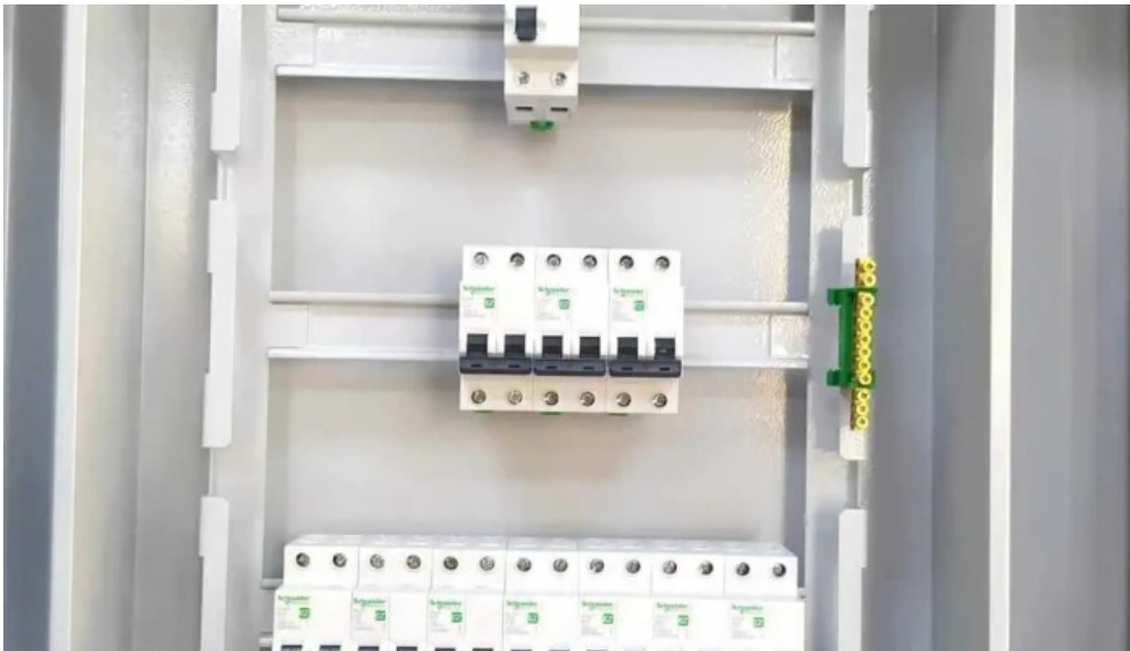
Rs tecnico en instalaciones electricas del propietario
