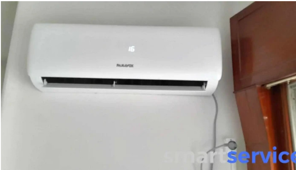
Electricidad ibarra del propietario
