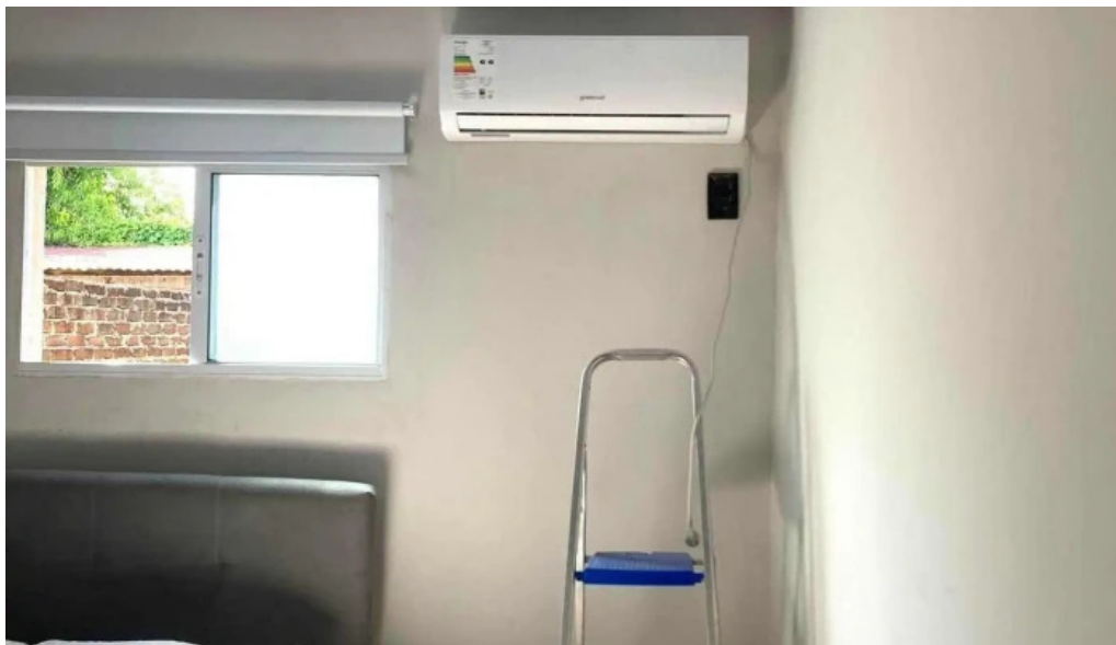
Electricidad ibarra interior
