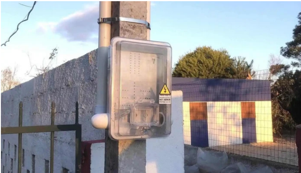
Ricardi instalaciones electricas del propietario
