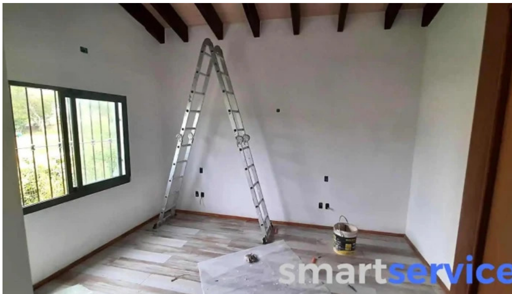
Damian electricidad interior
