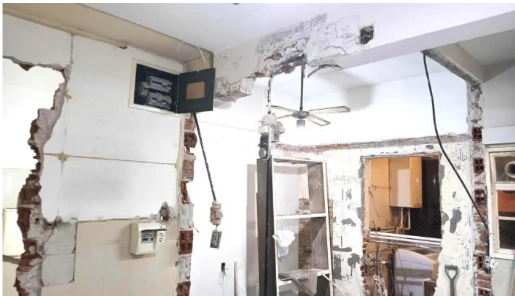
Sepo servicios electricos interior
