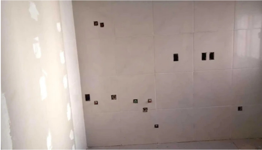
Safe instalaciones interior
