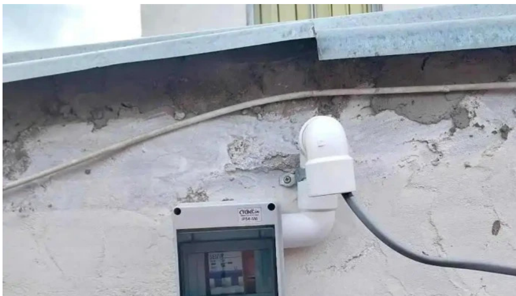
Electricista diego del propietario
