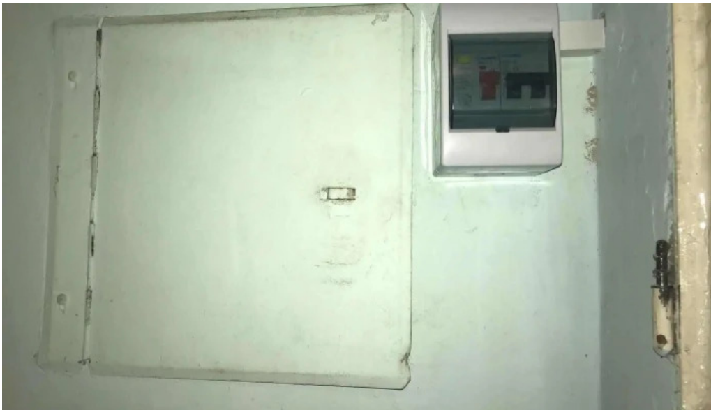
Cr instalaciones interior
