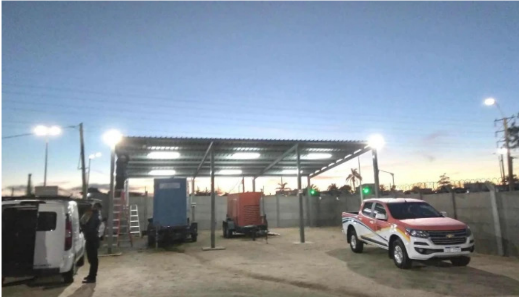
Gelectric instalaciones instalaciones
