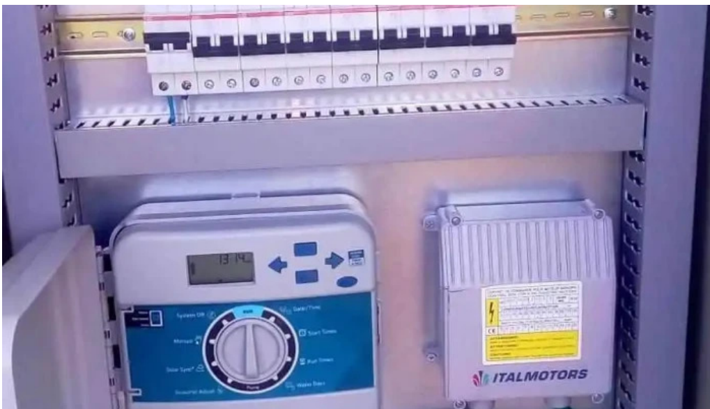
Gelectric instalaciones interior
