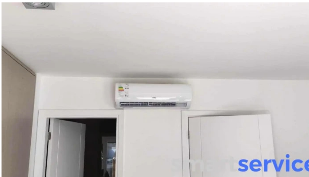
Aire acondicionado electricista fava aire acondicionado e instalaciones electricas del propietario
