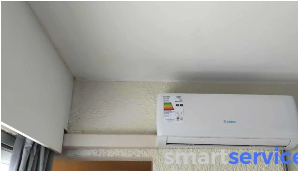
Aire acondicionado electricista fava aire acondicionado e instalaciones electricas interior
