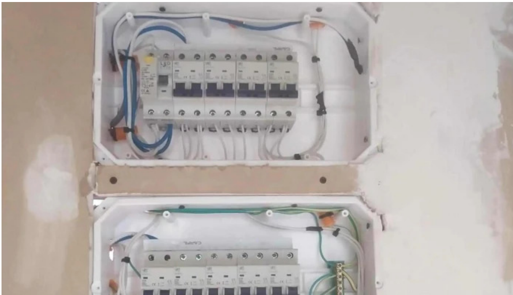
Mc instalaciones electrica comentario 11
