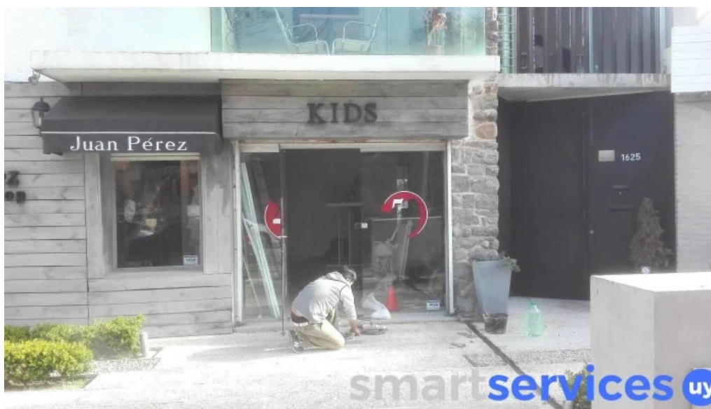
Amplificaciones audio e iluminacion instalaciones electricas exterior
