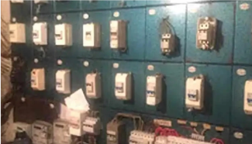
Fraga electricidad ciudad de la costa
