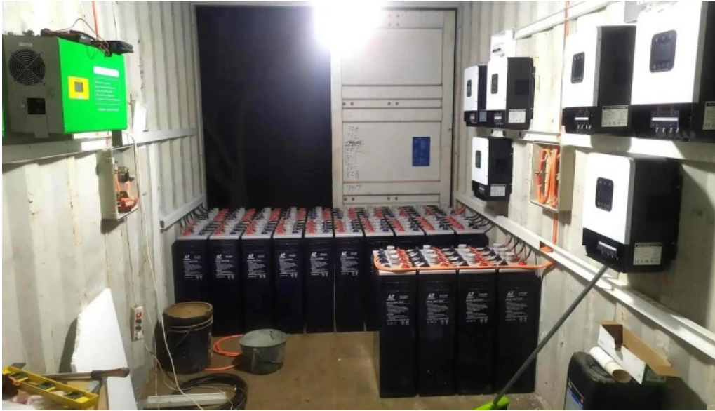
Adf electricidad interior
