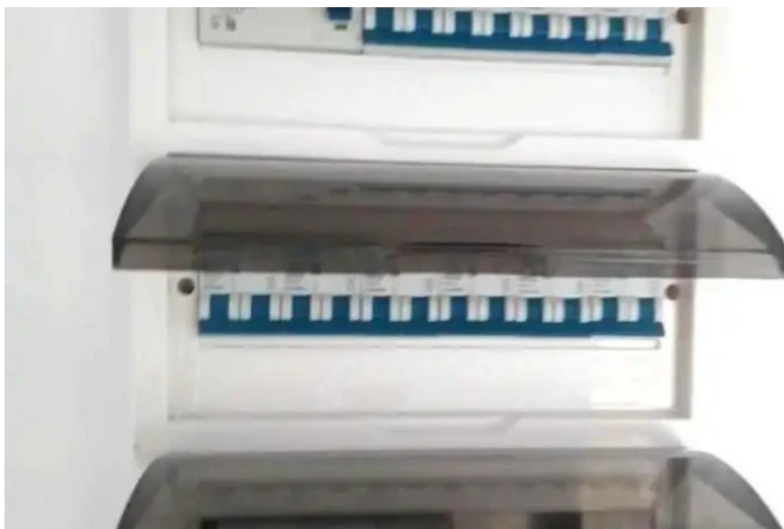
Carlos quiroga electricidad cardal
