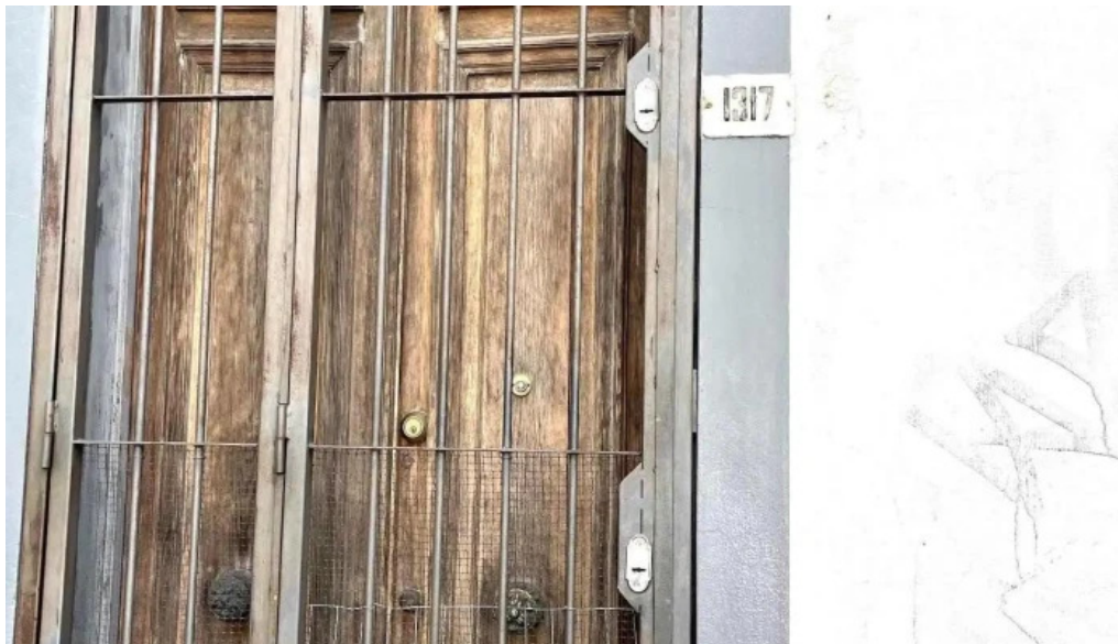
Cerrajería del cordón seguridad
